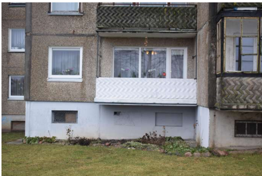
4. pav. Balkono perdangos fotofiksacija
